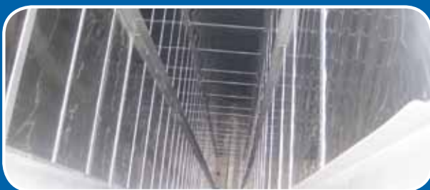
Blick von oben in den 50 Meter tiefen Schacht mit den integrierten Nießing Plattenschwingersegmenten.
