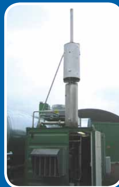
Einhausung eines Biogasaggregates in einem Container unter Berücksichtigung einer adäquaten Schalldämpfung.
