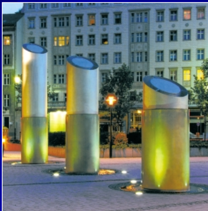
3 wasserüberströmte Abluftanlagen - Pariser Kommune, Berlin
